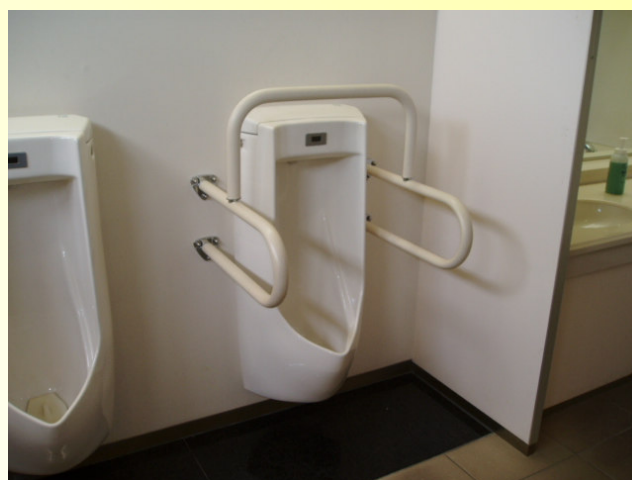
男性用トイレ手すり
