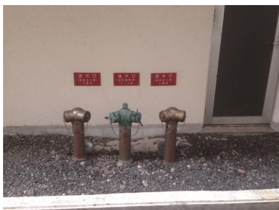
そうすいこう 送水口（写真提供 消防署）
