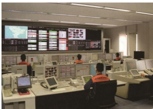
しょうぼうきょくつうしんしれいしつ 消防局通信指令室 (写真提供 横須賀市消防局)
