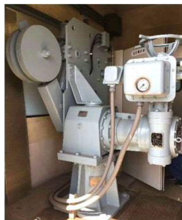
緊急遮断弁（高山配水池）
