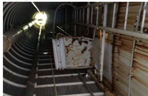
小網代配水塔の劣化が進行している階段部
