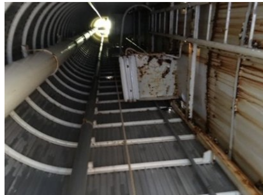
図3-2 小網代配水塔階段部の劣化状況
