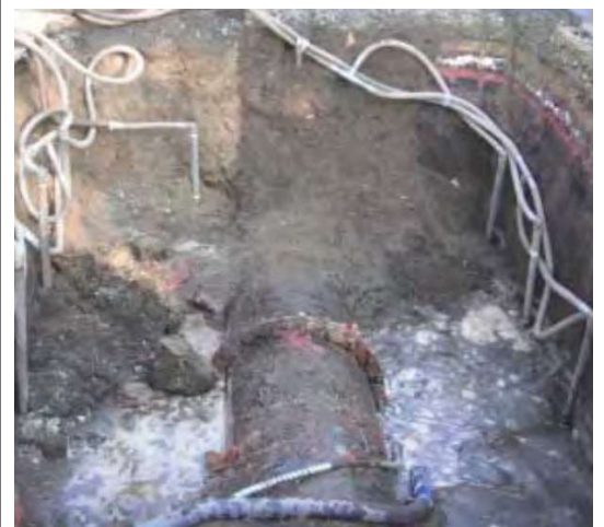
東日本大震災により被災した福島県いわき市の非耐震管(600mm)の漏水状況
