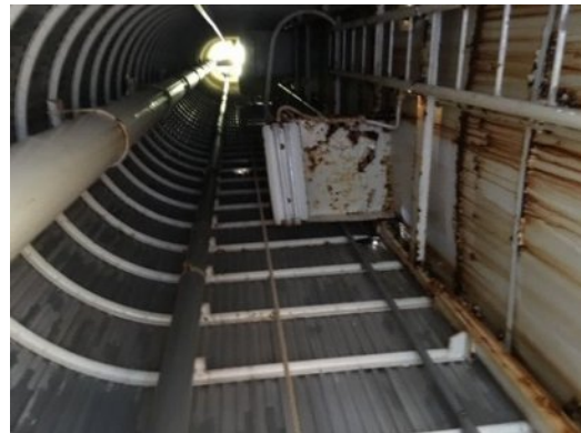
図3-2 小網代配水塔階段部の劣化状況
