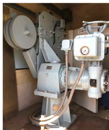
緊急遮断弁（高山配水池）
