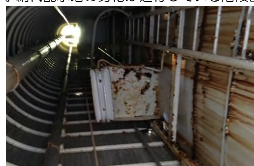
小網代配水塔の劣化が進行している階段部
