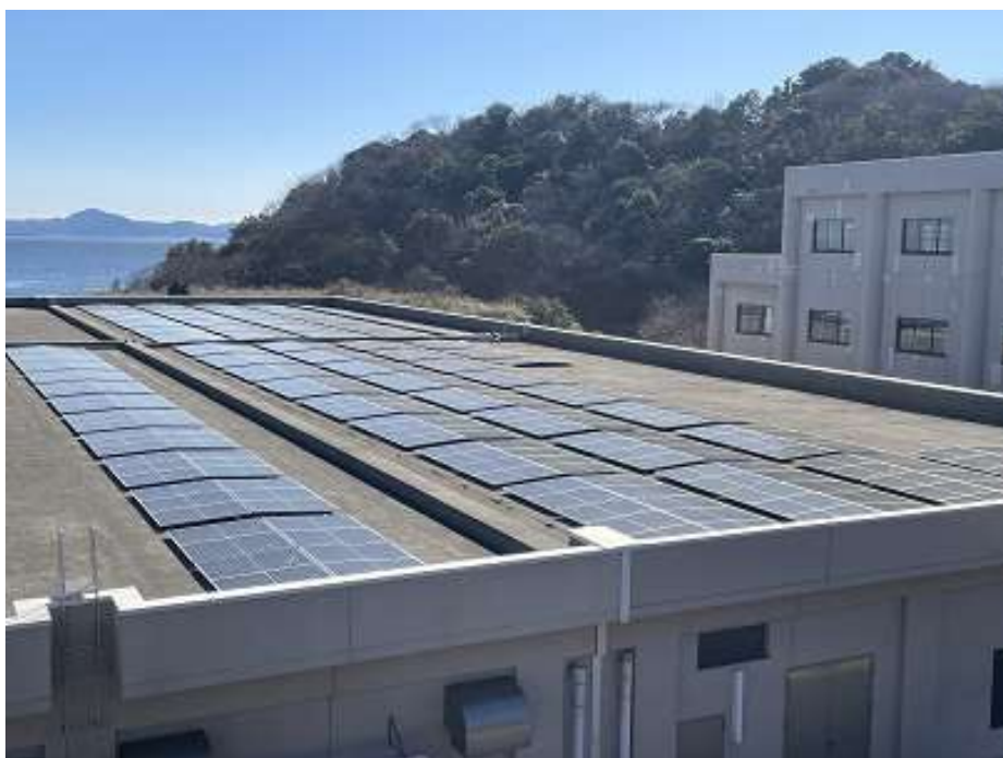
東部浄化センター太陽光発電設備工事
