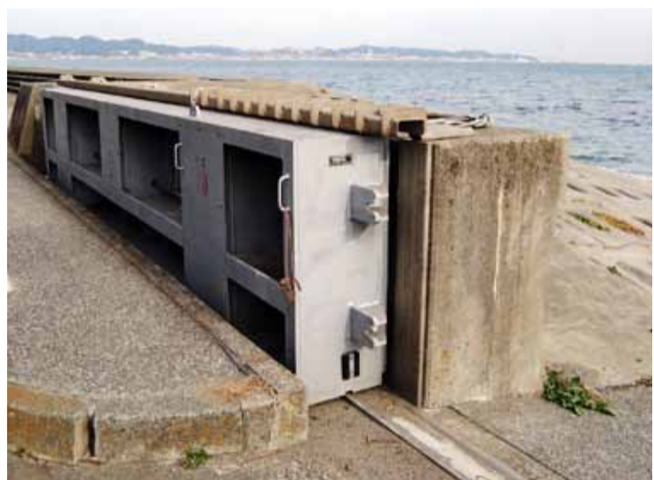
沿岸地域に設置されている防潮扉
