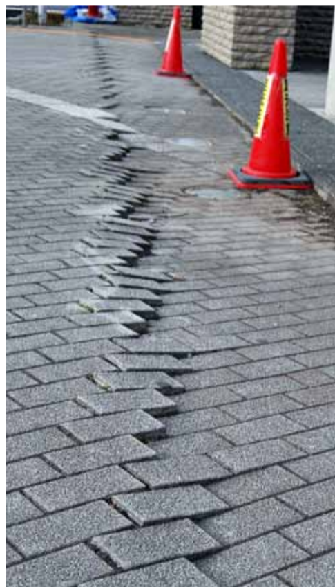
沈み込んだインターロッキング
