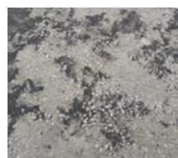
某小学校のグラウンド砂が流出し礫のようなものがむき出しになっている。
