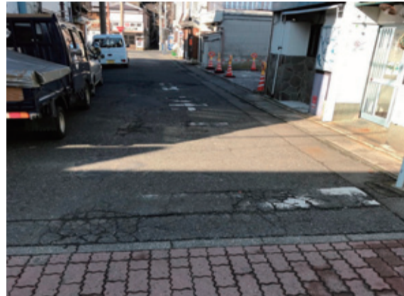
かすれた路面標示
