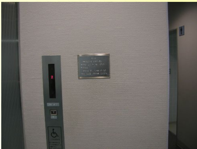
エレベーター入口操作盤
