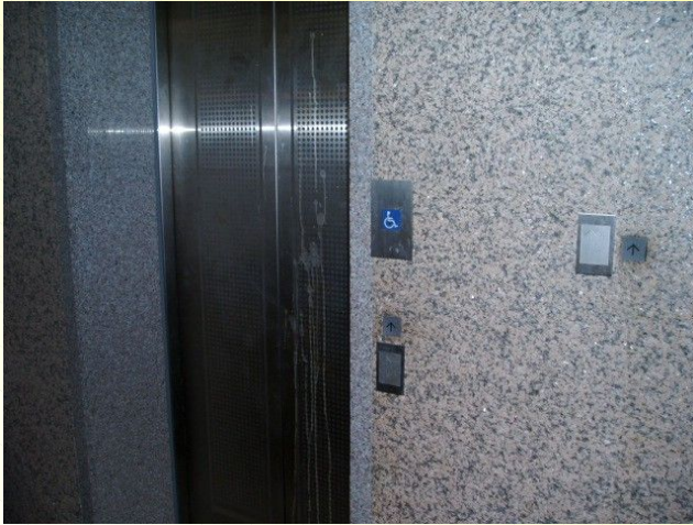
エレベーター
