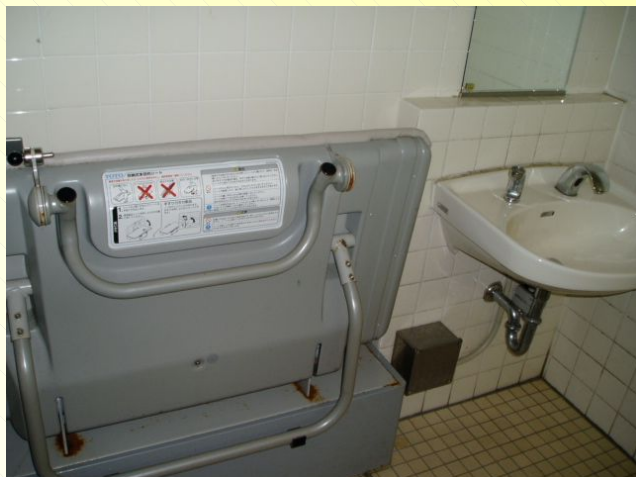
多目的トイレ内部（ベビーベッド）
