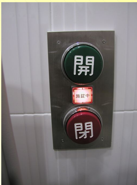
トイレ自動ドア開閉ボタン
