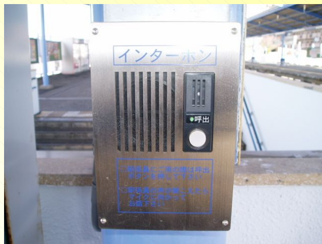
インターホン設置状況
