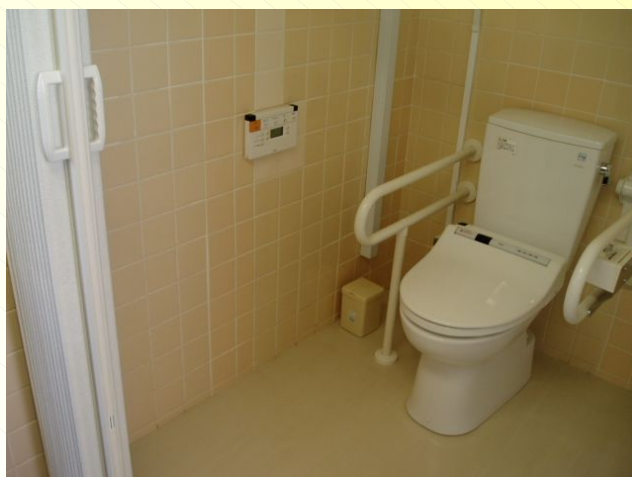
車いす対応トイレ
