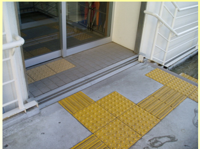
2階入口（点字ブロック自動ドア）
