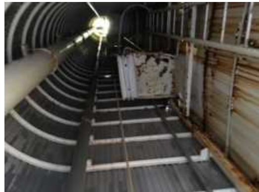
図3-2 小網代配水塔階段部の劣化状況
