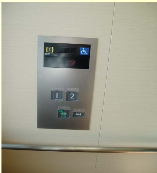
エレベーター内操作版
